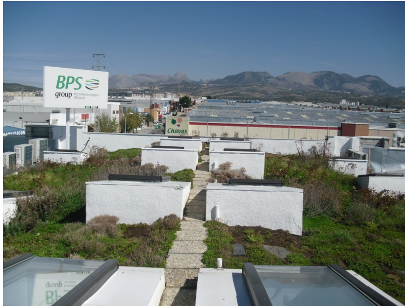
Estado final de la construcción de la cubierta vegetal implantada en la nave de BPS Group
